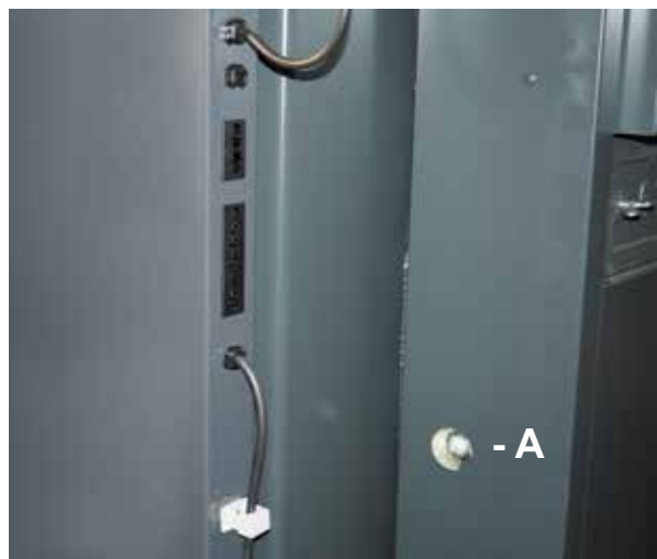
A - otwór do pomiaru realnej zawartości (nadmiaru) O_2 w spalinach przy spalaniu peletu
